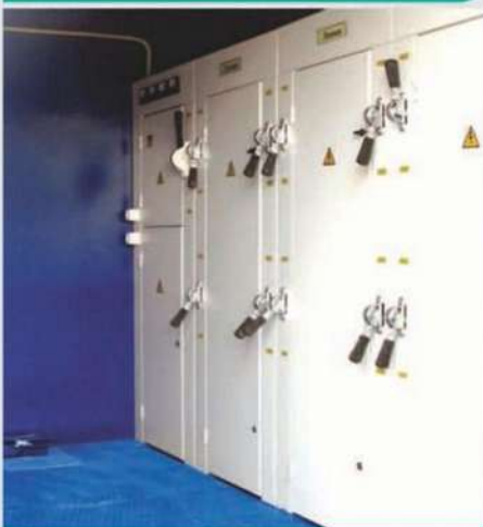
Распределительное устройство 0,4 кВ
