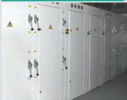
Распределительное устройство 0,4 кВ
