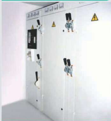
Распределительное устройство 0,4 кВ
