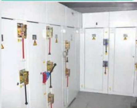
Распределительное устройство 10 кВ
